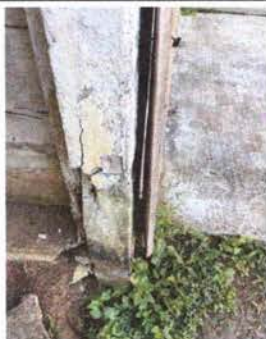
Foto 1: SE OBSERVA EL DETERIORO DE LA COLUMNA DEL AULA DONDE RECIBEN CLASES LOS NIÑOS ACTJUALMENTE
